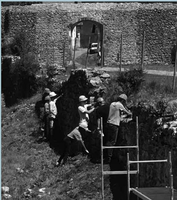
Visite d'un chantier du village des jeunes dans le Champsaur. Suite à cette visite, 3 jeunes demandeurs d'asile participeront à un chantier international.
